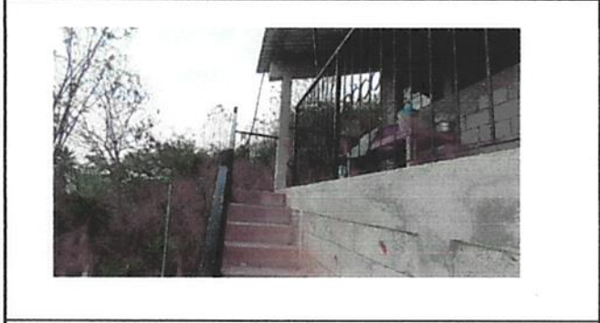
FOTO 3: AMPLIACION Y MEJORAMIENTO DE LA BARANDA PARA EVITAR CAIDAS DE ALUMNOS
